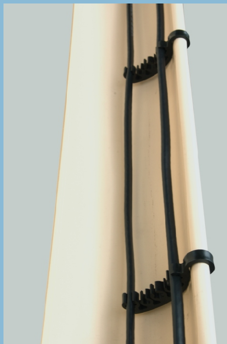
Нагревательный кабель, установленный в желобе, при помощи клипс.
